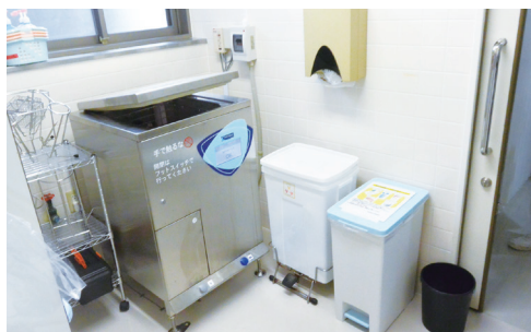
写真2. 整理整頓された 汚物処理室 (不潔ゾーン)
