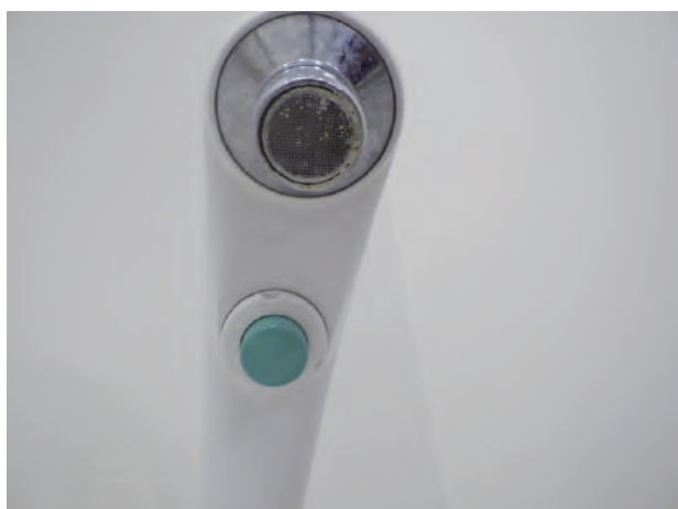
図3 整流器に目に見える汚れが付着しているシャワーヘッド シャワーヘッドは交換時期に決まりがないため、汚染されたまま使用されがちである
