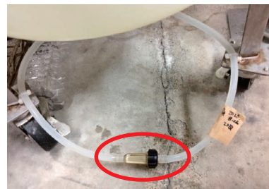
図2 発生箇所(破損したフィルタの場所)
