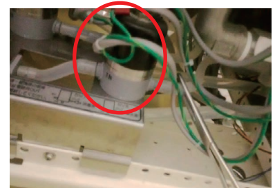
図3 発生箇所(原因の薬液電磁弁)
