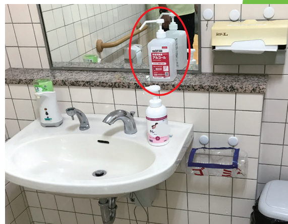
図5 手洗い場③(アルコール手指消毒剤設置)
