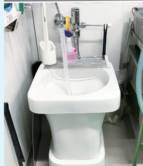
中央材料室に設置されていた汚物流し
