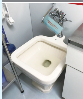
もともと設置されていた汚物流し
