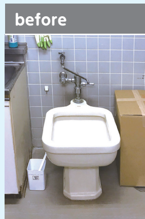
もともと設置されていた汚物流し
