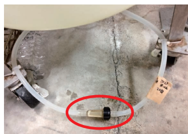
図2 発生箇所(破損したフィルタの場所)
