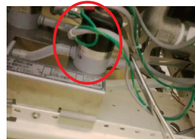
図3 発生箇所(原因の薬液電磁弁)
